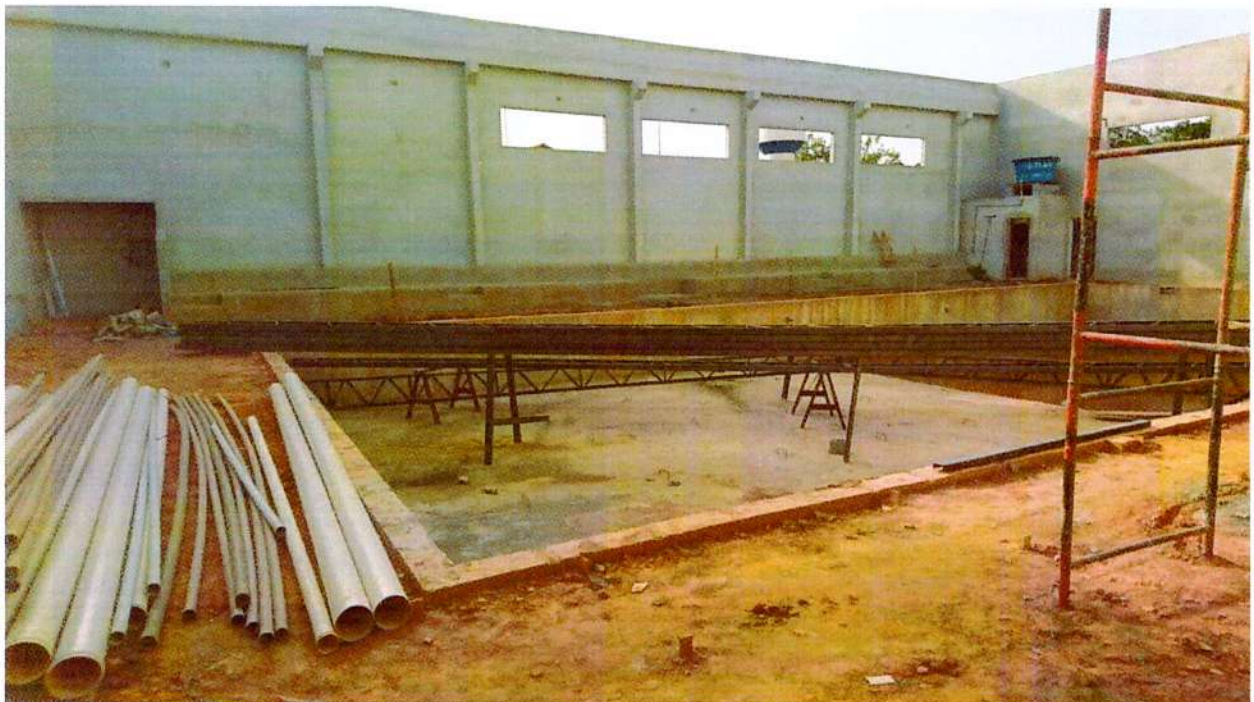
Foto 3 – Área da Piscina. Serviços Pendentes: Cobertura, esquadrias, hidráulica, elétrica, acabamento final piso e paredes.
