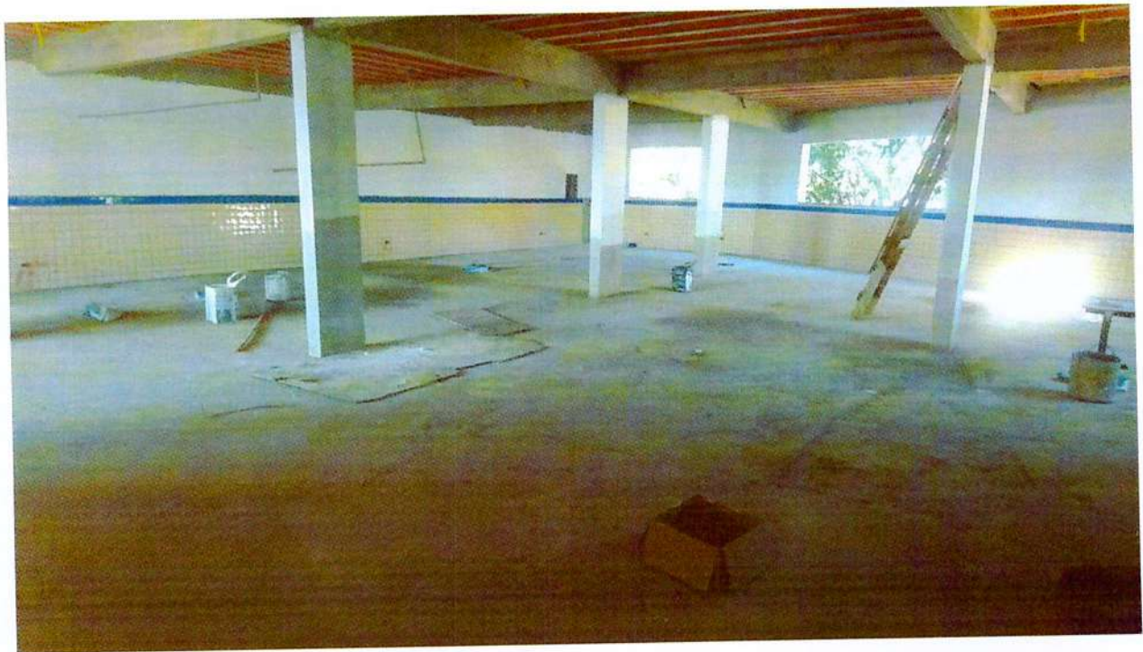
Foto 4 - Salão piso superior. Serviços Pendentes: Fiação definitiva, esquadrias, acabamento final parede e piso (forro, pintura e cerâmica)
