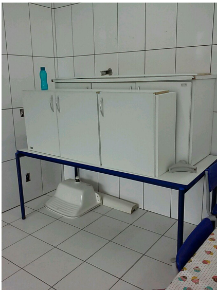
Os gabinetes não estão instalados.
