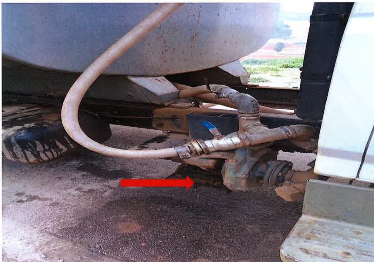
Vazamento constante de água.
