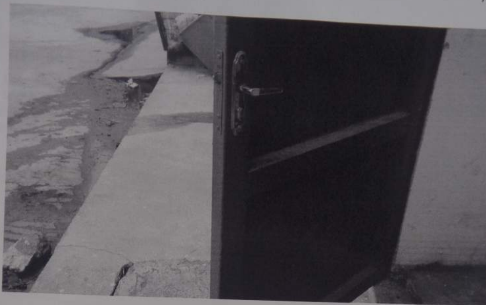
Portão de entrada (maçaneta quebrada)
