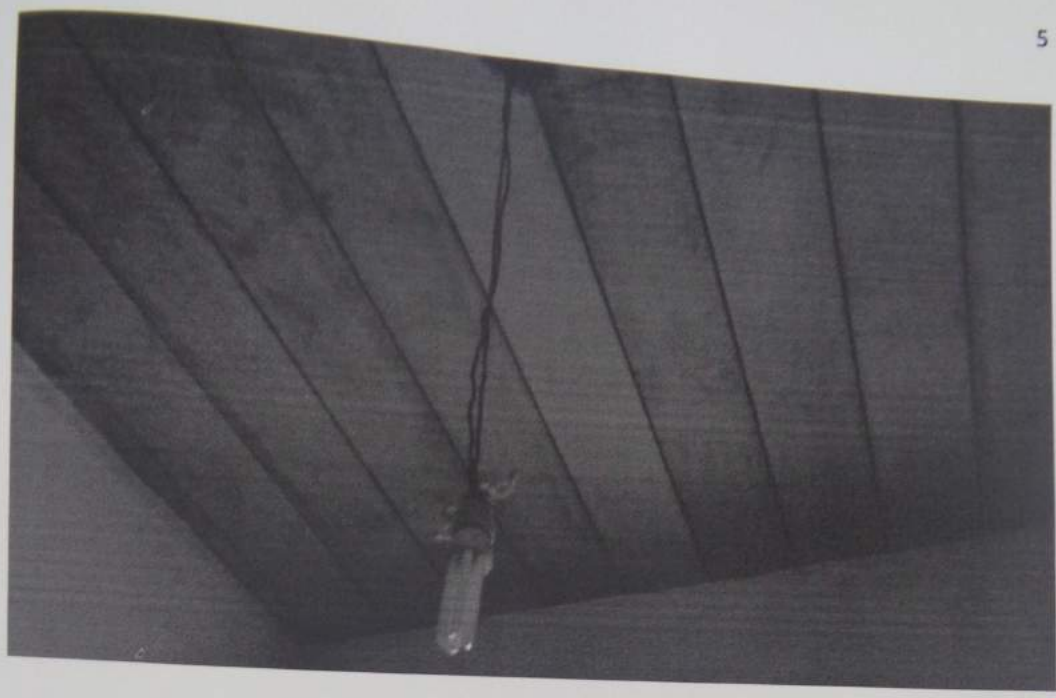
Instalações elétricas precárias
