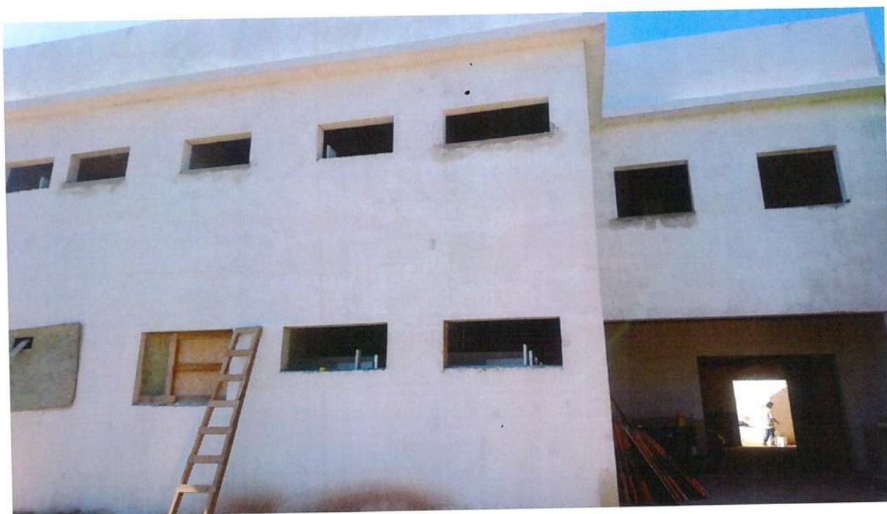
Foto 2 - Fachada Principal. Serviços pendentes: Pintura e esquadrias.
