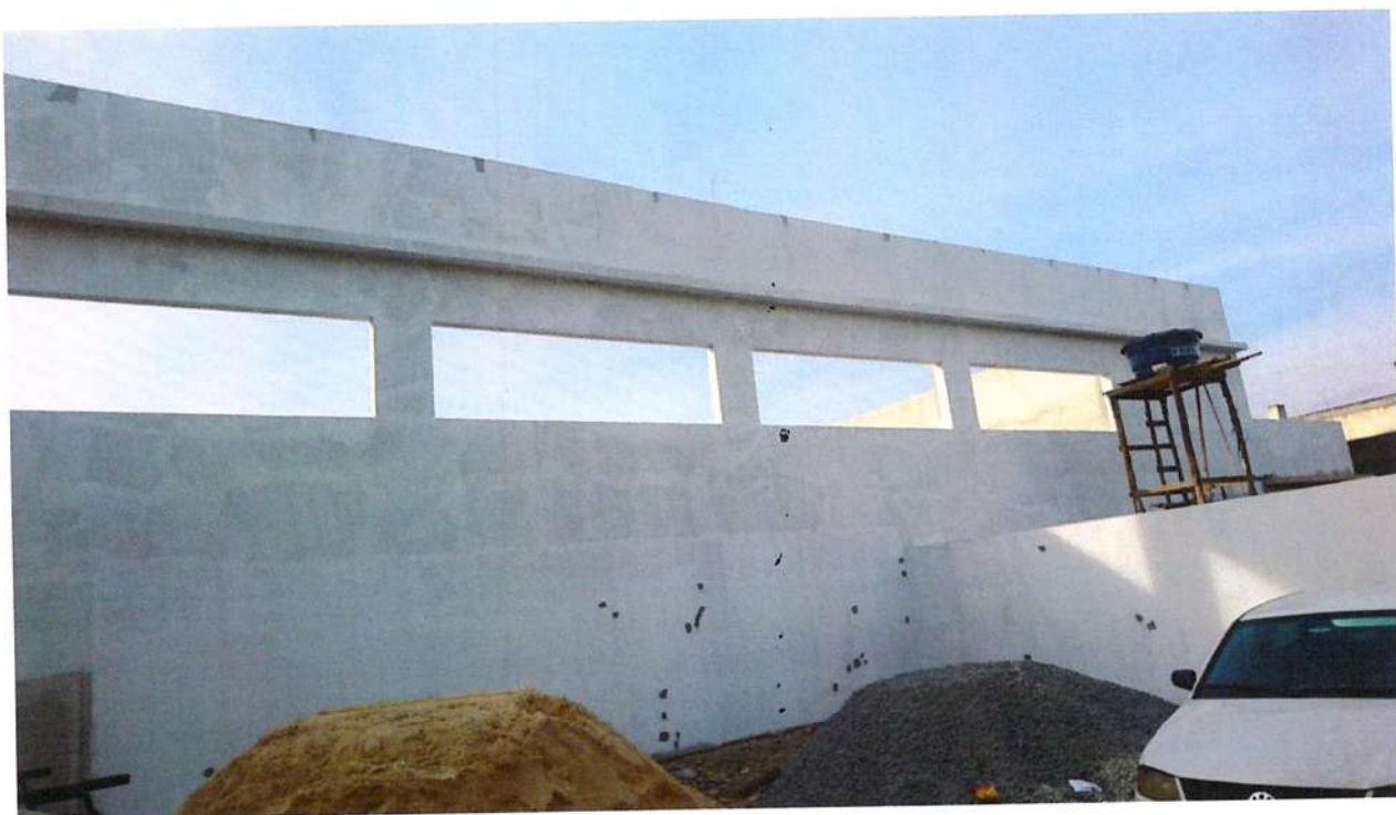
Foto 1 - Fachada Lateral. Serviços pendentes: Pintura e esquadrias.
