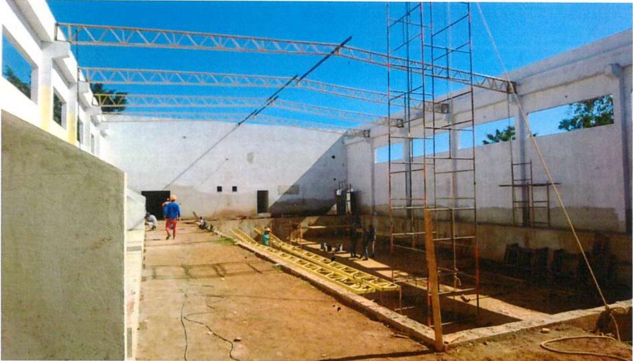
Foto 3 – Área da Piscina. Serviços Pendentes: Cobertura, esquadrias, hidráulica, elétrica, acabamento final piso e paredes.
