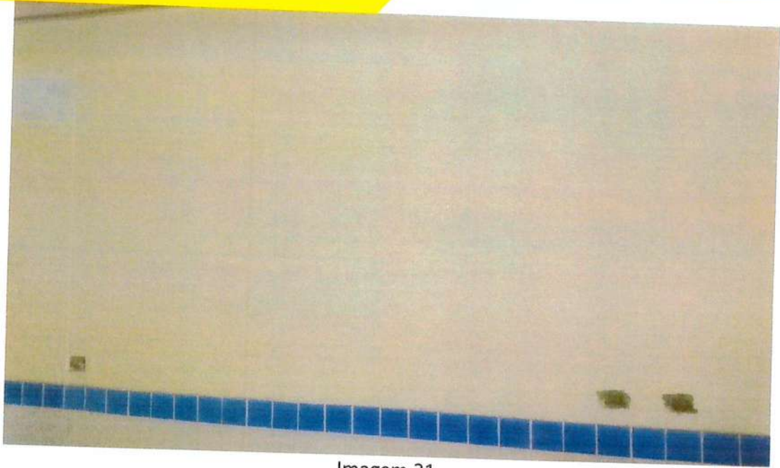
Imagem 21 - Falta passagem a fiação de elétrica.
