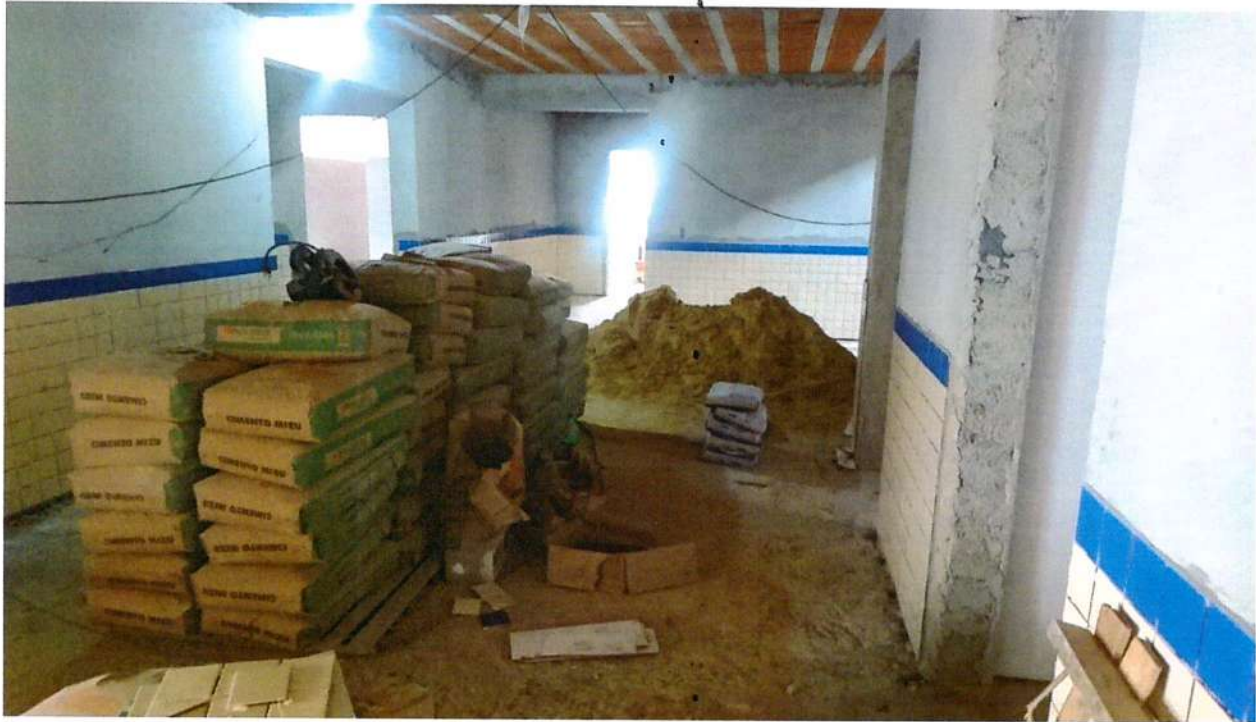
Foto 4 – Hall de entrada. Serviços Pendentes: Fração definitiva, acabamento final parede e piso (forro, pintura e cerâmica)
