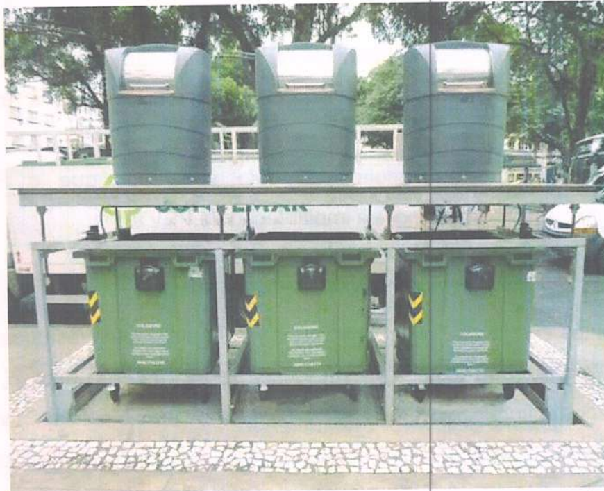
Figura 28. Contêineres para coleta de resíduos sólidos. Fonte: Imagens do Google.
