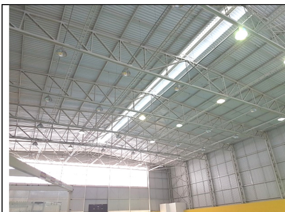
Foto - Vista da estrutura metálica, lanternim, luminárias e veneziana lateral, no interior do ginásio do CIE, Santana de Parnaíba (SP), 23.05.2019.
